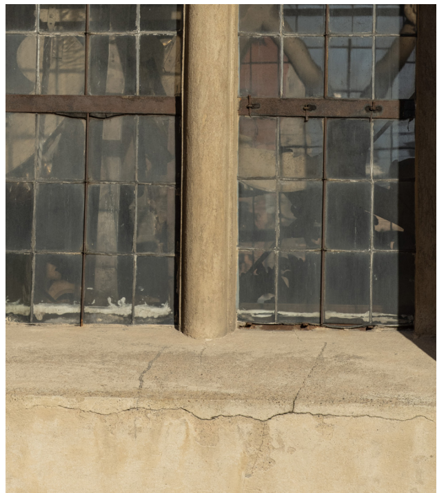
Kościół pw. św. Józefa Oblubieńca NMP we Wschowie elewacja południowa, widoczne spękania opaski okiennej, fragment.
