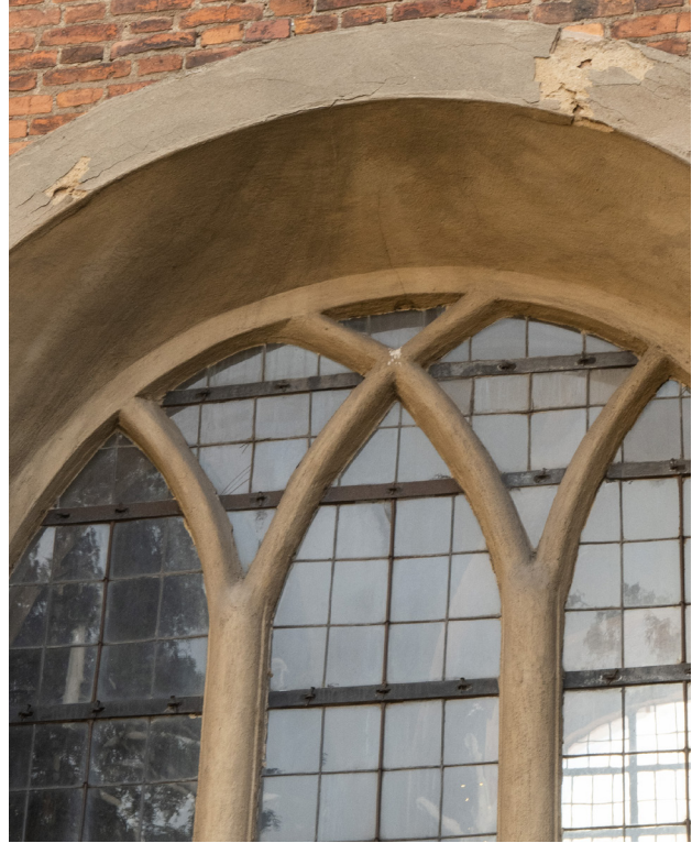
Kościół pw. św. Józefa Oblubieńca NMP we Wschowie elewacja północna, widoczne złuszczenia opaski okiennej, fragment.
