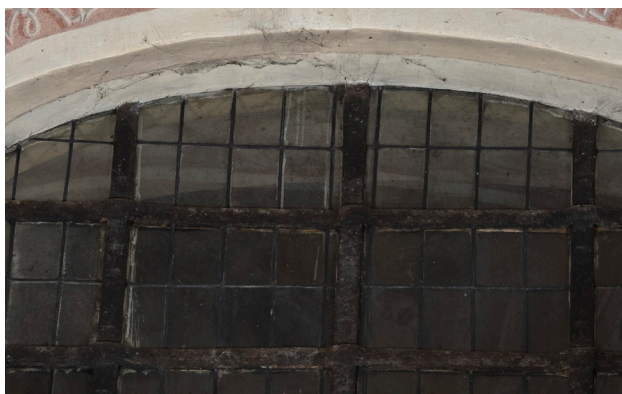
Zaawansowana korozja elementów żelaznych i zniszczenia ołowiu.
