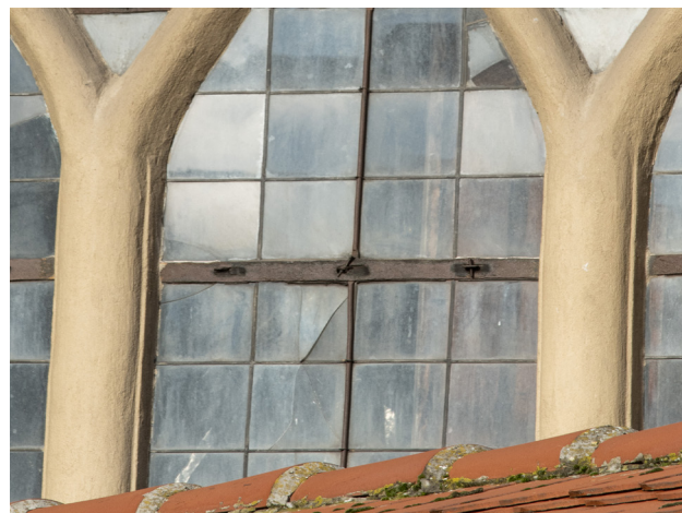
Pęknięcia szyb witrażowych powstałe w wyniku urazów mechanicznych.
