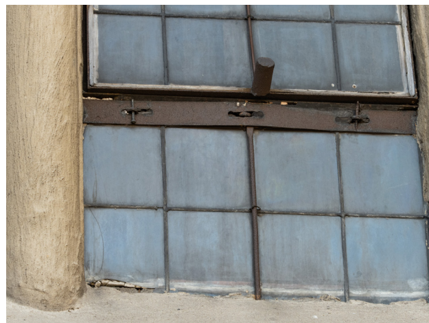
Zniszczenia ołowiu i elementów żelaznych wpływające na destabilizację całych połączeń szkła.
