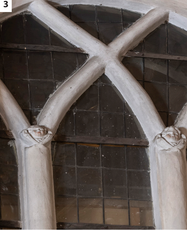
Kościół pw. św. Józefa Oblubieńca NMP we Wschowie ściana północna, widoczne mocno zniekształcone licznymi remontami uskrzydłone głowy anielskie..
